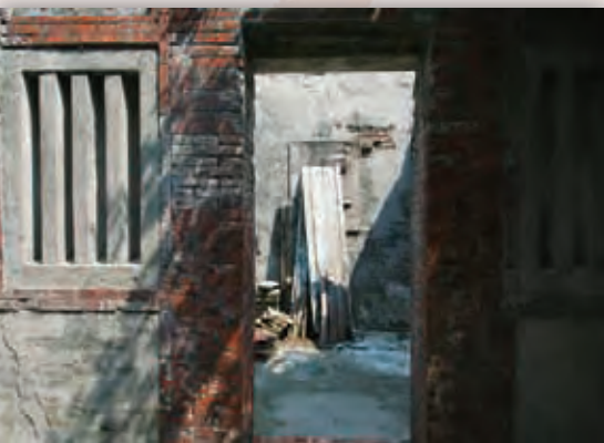
▲庭園側邊牆面修復前。
