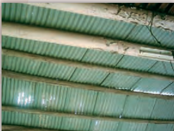
▲廳堂屋桁修復前。
