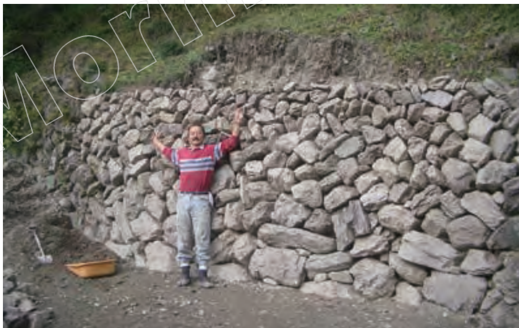
里山生活第五年，重建了斜坡下這道年久失修的崩壞石牆。工程期間零零總總算起來大約一個月，我在那段期間瘦了 5kg。
